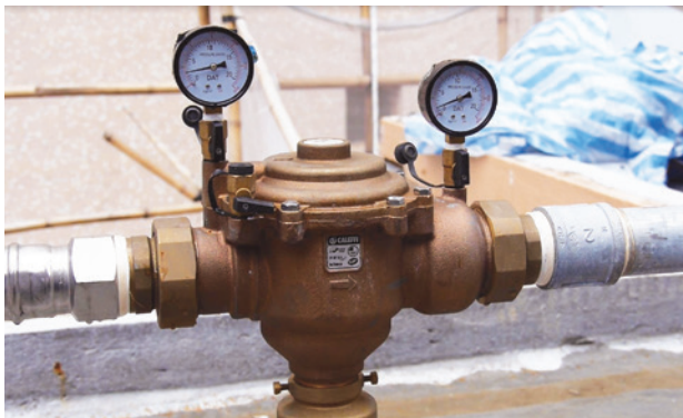
消防處與水務署合作，嶄新的消防裝置採用了防止回流裝置，以免食水受滅火用水污染。
